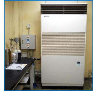
▲恒温恒湿室エアコン
